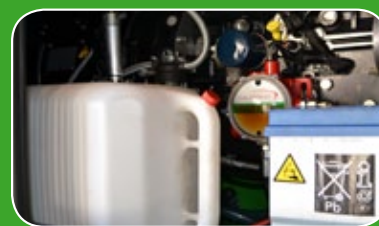
3 Tanque de água destilada
