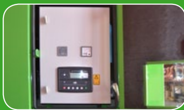
5 Painel de controlo
